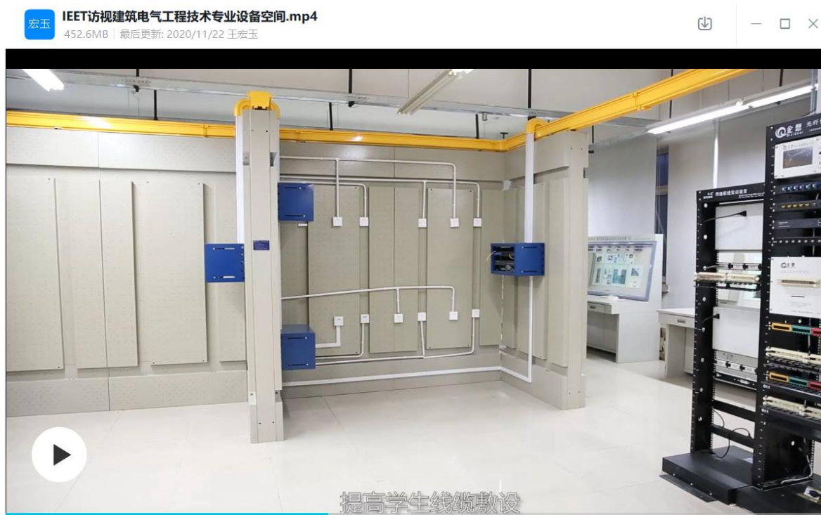
IEET 项目《建筑供电与照明》实训场地
