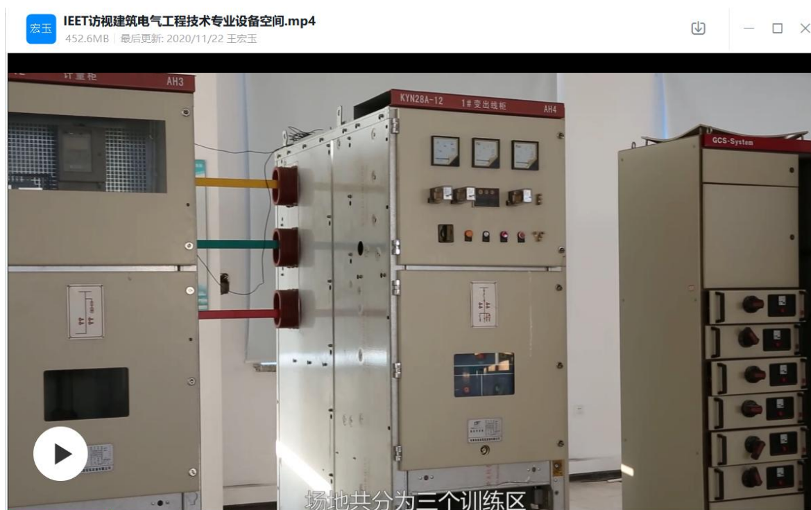
IEET 项目《建筑供电与照明》实训场地
